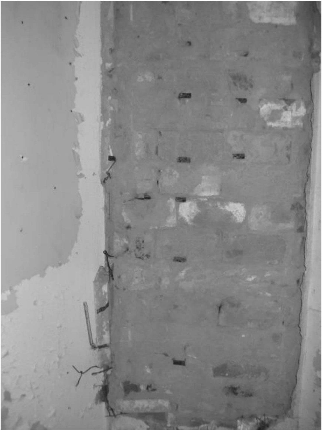
Рис. 78. Дача лигера Б. Комната 3. Печъ, облицовка утрачена. Декабрь 2011 г.
