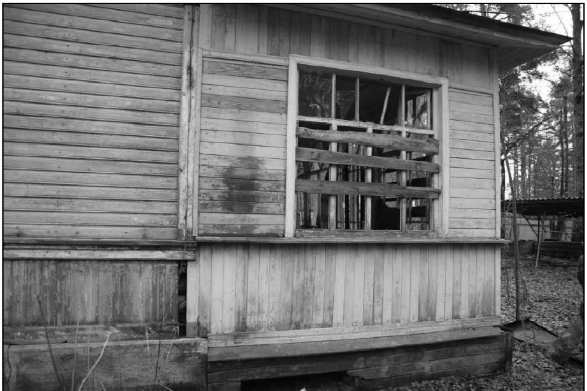
10. Объект культурного наследия «Дача» (пос. Комарово. Морская ул., 8). Вид на веранду со стороны западного фасада. Вид на юго-восток.
