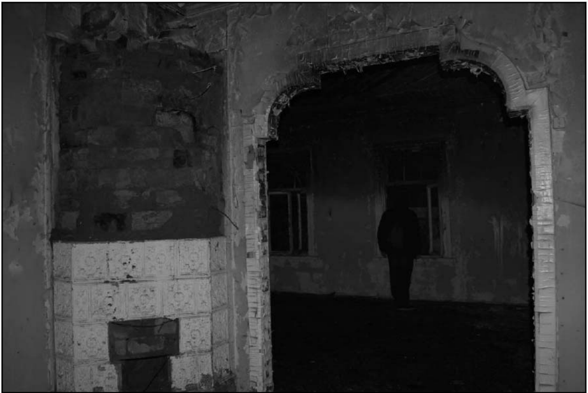
31. Объект культурного наследия «Дача» (пос. Комарово. Морская ул., 8). Помещение № 2. Изразцовая печь с утратами и арочный проем в помещение № 10.
