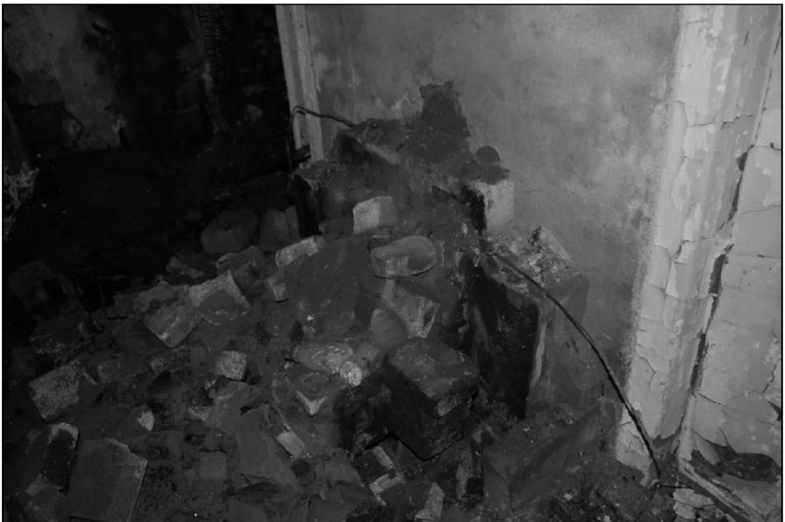
30. Объект культурного наследия «Дача» (пос. Комарово. Морская ул., 8). Помещение № 10. Фрагмент разрушенной изразцовой печи.
