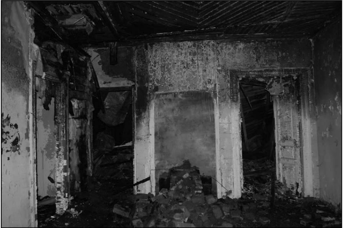
29. Объект культурного наследия «Дача» (пос. Комарово. Морская ул., 8). Помещение № 10. Дверные проемы в помещения № 8 и № 9. Разрушенная изразцовая печь.
