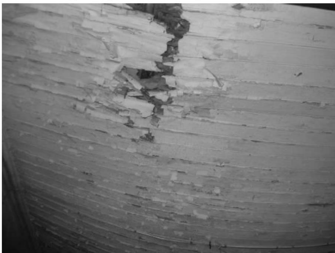
Рис. 74. Дача литеры Б. Комната 4. Потолок. Декабрь 2011 г.
