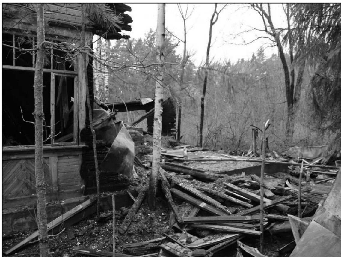
4. Объект культурного наследия «Дача» (пос. Комарово. Морская ул., 8). Сгоревшая северная часть дачи. Фрагмент восточного фасада. Вид на север.
