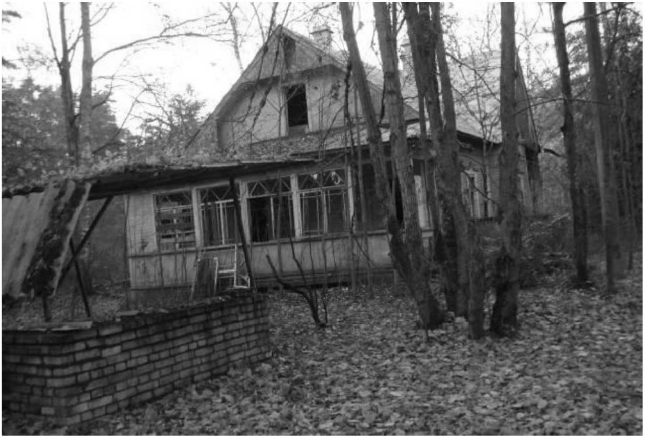
Рис. 49. Вид на южный фасад Дачи литера Б со стороны обрыва. Декабрь 2011 г.
