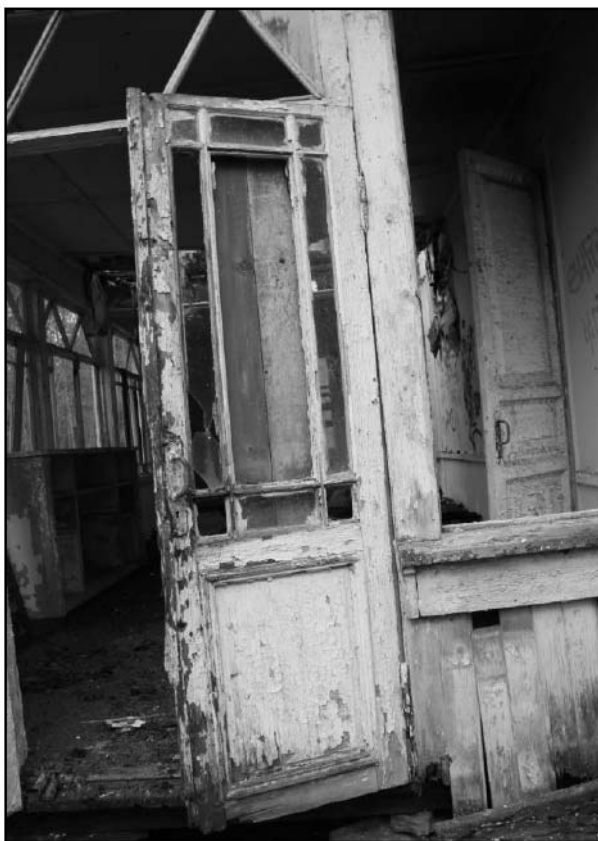
15. Объект культурного наследия «Дача» (пос. Комарово. Морская ул., 8). Створка входной двери на веранду восточного фасада.
