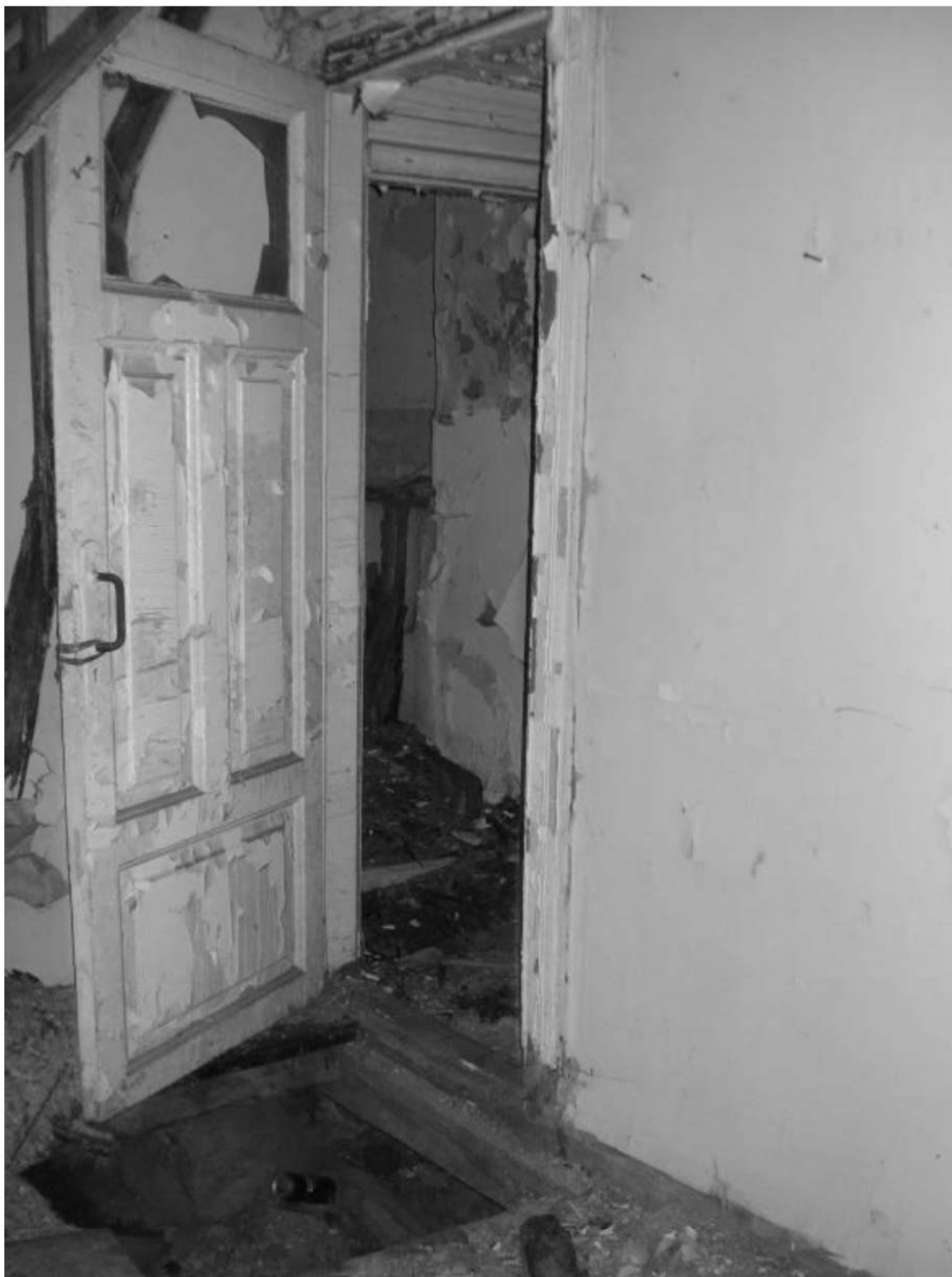
Рис. 83. Дача литеры Б. Комната 9. Декабрь 2011 г.
