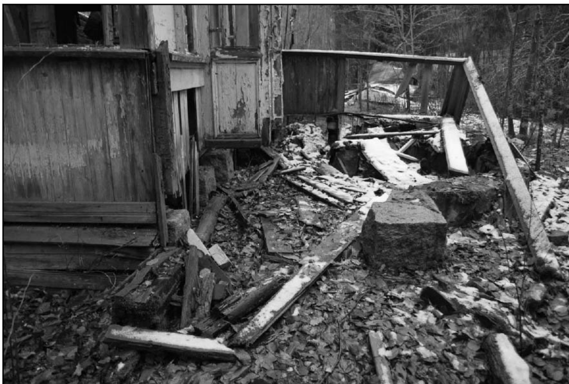
13. Объект культурного наследия «Дача» (пос. Комарово. Морская ул., 8). Фрагмент восточного фасада. Вид на террасу со стороны южного фасада.
